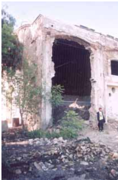
Perforación hecha en uno de los costados de la sala de motores. Termoeléctrica de la Potosina Electric Co. Agosto de 2006.
